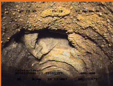
Aantasting van de rioolbuizen door ongewenst biochemisch proces
